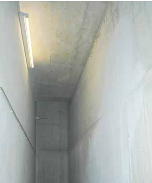
oben: Der Blick in den mehr als 90 Meter langen Erdkanal zur Klimatisierung der Schweinfurter Büroräume mittels Erdwärme und -kühle.
