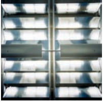
Indirekte Bürobeleuchtung über Breitbandreflektoren.
