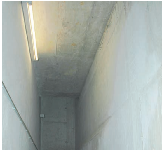
Der Blick in den mehr als 90 Meter langen Erdkanal zur Klimatisierung der Schweinfurter Büroräume mittels Erdwärme und -kühle.
